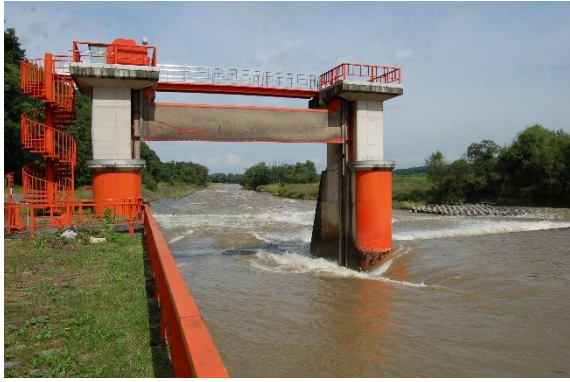
写真1 雨紛頭首工。かんがい用として石狩川水系美瑛川の左岸から取水し雨紛地区～神居・忠和地区へ水を流す。
