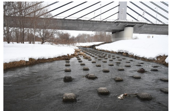
写真8 コンクリートブロックが露出(2025年3月16日)
