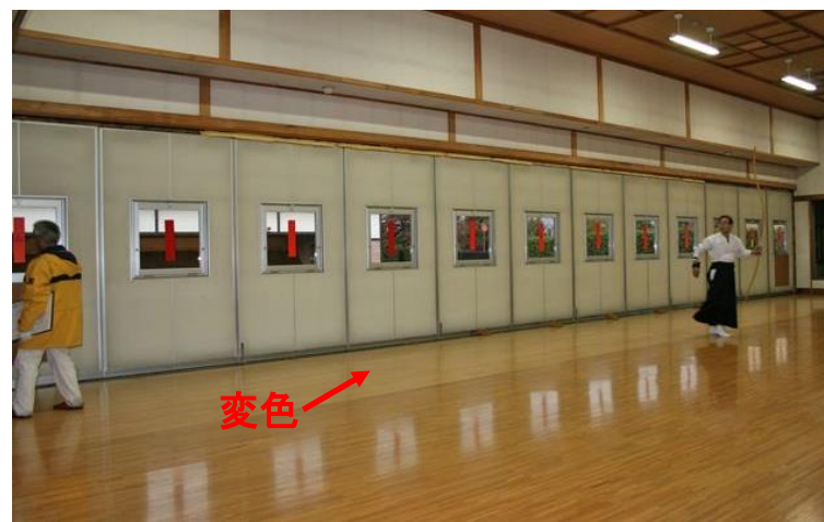
和弓場 射場床材の劣化
