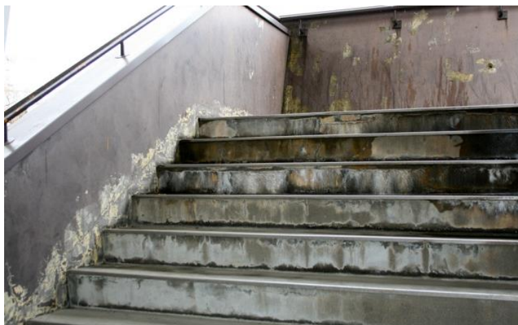
床・階段・壁全ての躯体劣化
