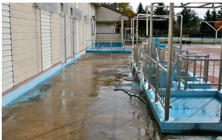
プール床材の剥離・欠損
