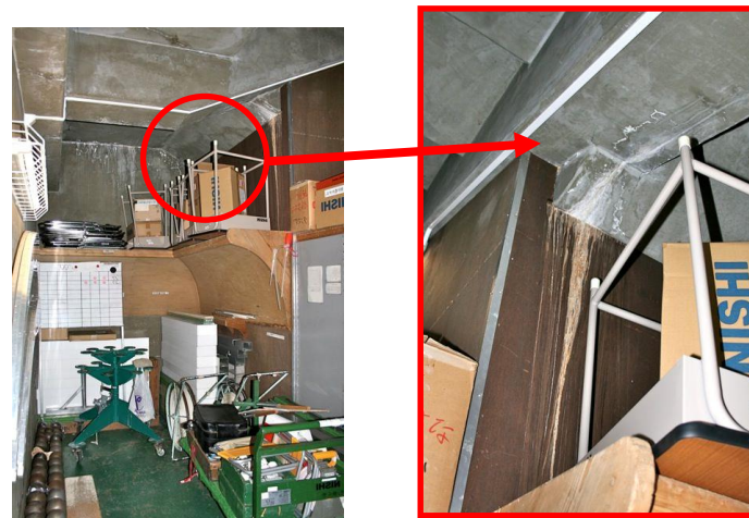
スタンド防水劣化による器具室への漏水・白華
