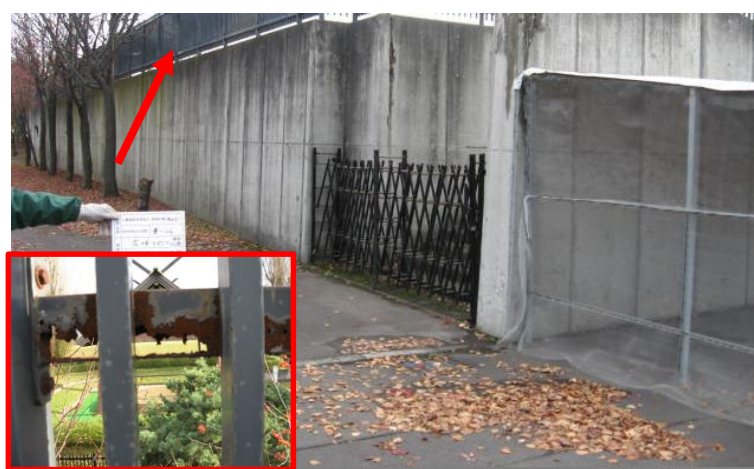
スタンド擁壁部と外柵劣化による貫通孔
