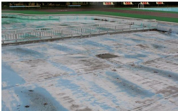
プール槽の塗装劣化 (25m・幼児用)
