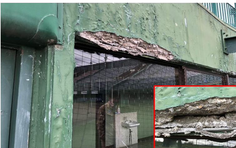
放送席窓上部のコンクリートの剥離
