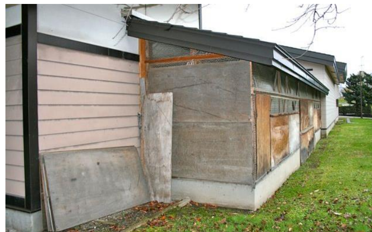
和弓場 渡廊下の仮設外壁による雨漏り
