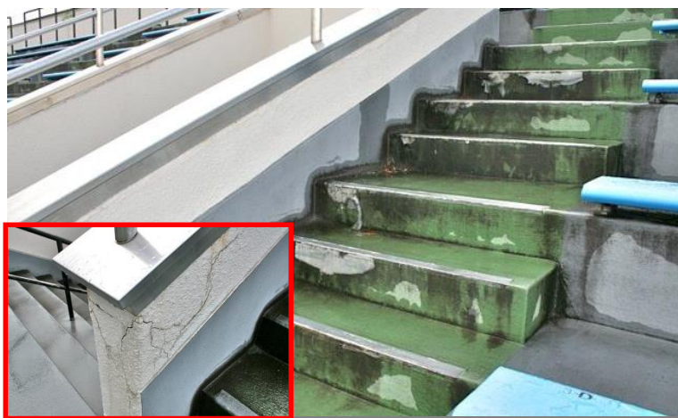
スタンド防水劣化・手摺下の躯体の劣化（クラック）
