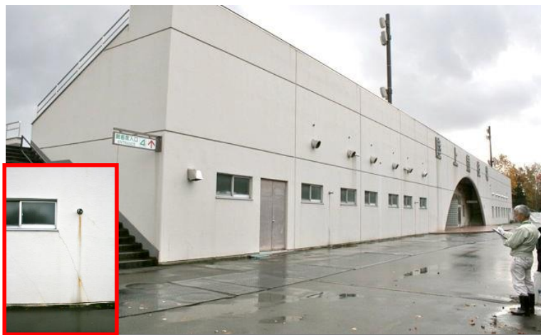
管理棟全景・外壁の発錆及びクラック
