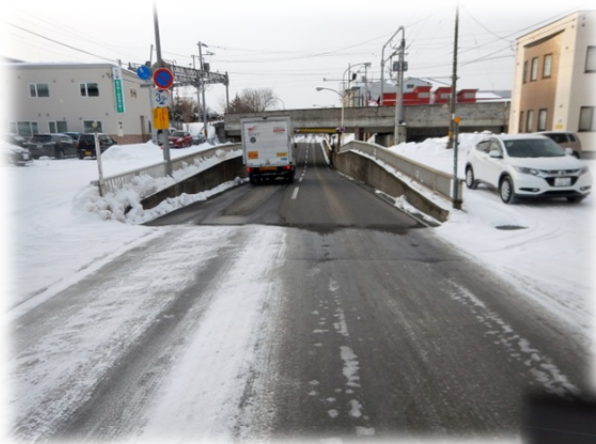
ロードヒーティング状況 (車道)
