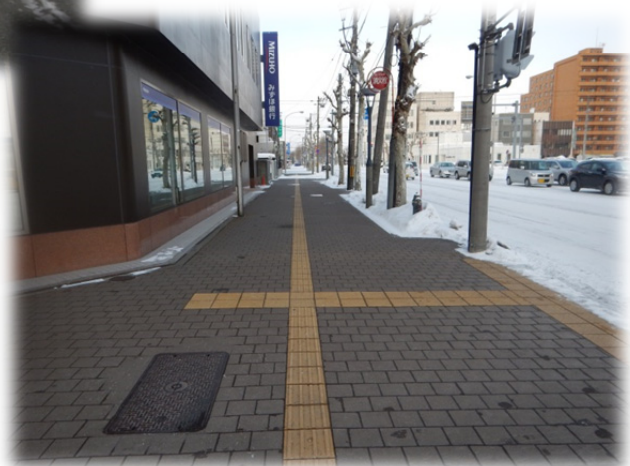
ロードヒーティング状況 (歩道)
