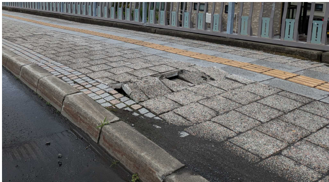
平板ブロックの破損（がたつき）
