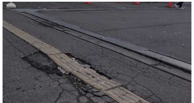
点字ブロックの破損（がたつき）
