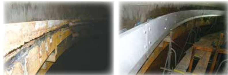
(下水道処理センター・更新前の古い設備と更新後の新しい設備)
