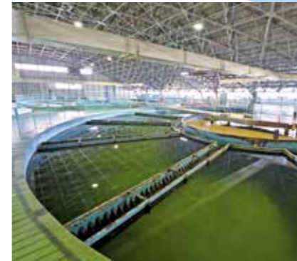
屋根付きの石狩川浄水場
