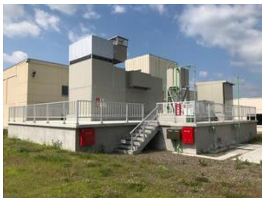
《石狩川浄水場非常用自家発電設備》
