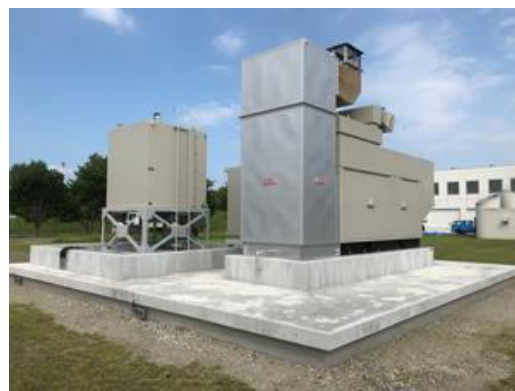
《忠別川浄水場非常用自家発電設備》
