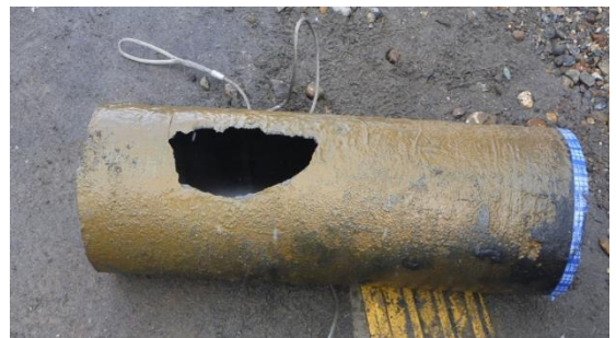
【さびて穴が開いた配水管】
