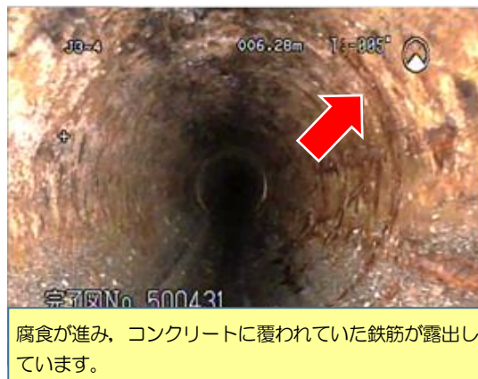
【腐食したコンクリート管】
