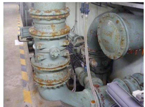
【石狩川浄水場のろ過池洗浄設備】
