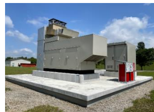
忠別川浄水場自家発電設備
