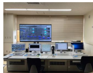
忠別川浄水場中央監視設備
