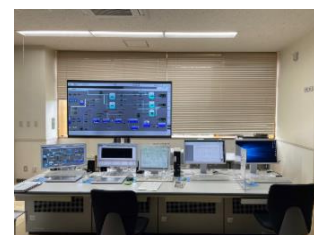
忠別川浄水場中央監視設備
