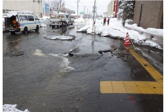
【本市で発生した漏水】
