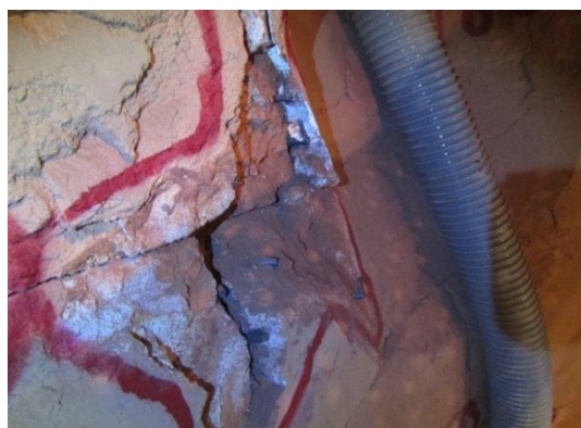
【下水処理センターの汚泥焼却炉（内部）】
