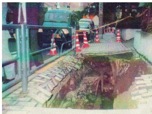
【下水管が原因で起きた道路陥没（他都市）】
