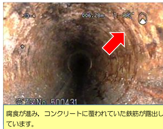
【腐食したコンクリート管】
