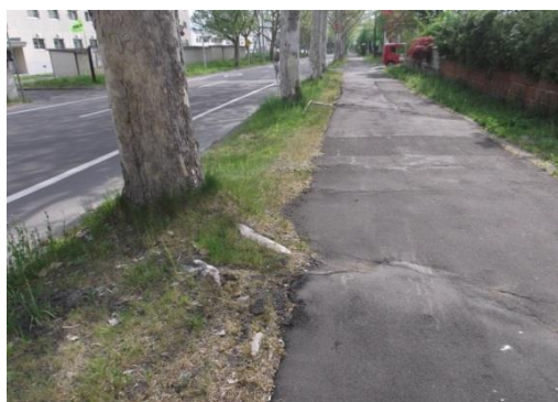
写真 2-4 根上がりによる歩道の盛り上がり
