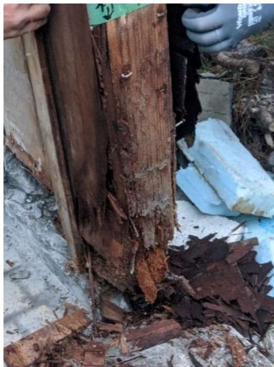
写真 4-4 劣化の確認(躯体の腐食)
