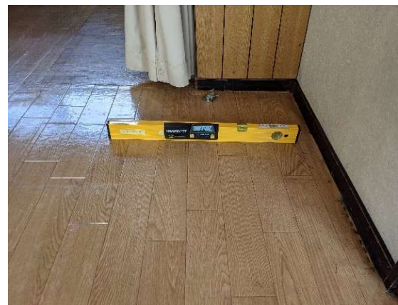
写真 4-5 劣化の確認(床の傾斜)
