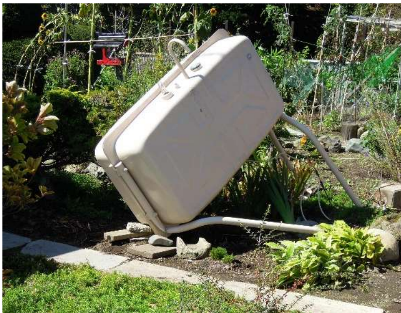
写真 7-2 地震による灯油タンク転倒被害
