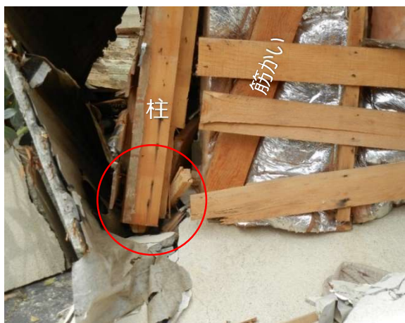
写真 4-2 柱の引き抜け事例
