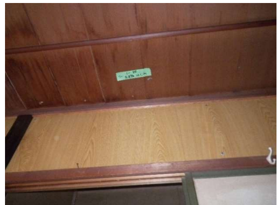
写真 4-1 劣化の確認(天井の水浸み)
