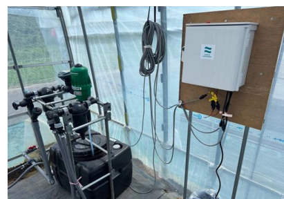
環境制御システム
