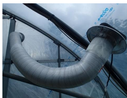
図3 ブロワー(妻面に吸気口を設置)
