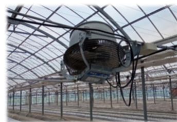
ハウスに設置された循環扇
