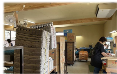
空調設備を設置した作業場
