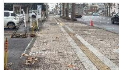
第三庁舎前の傷んだ舗装
