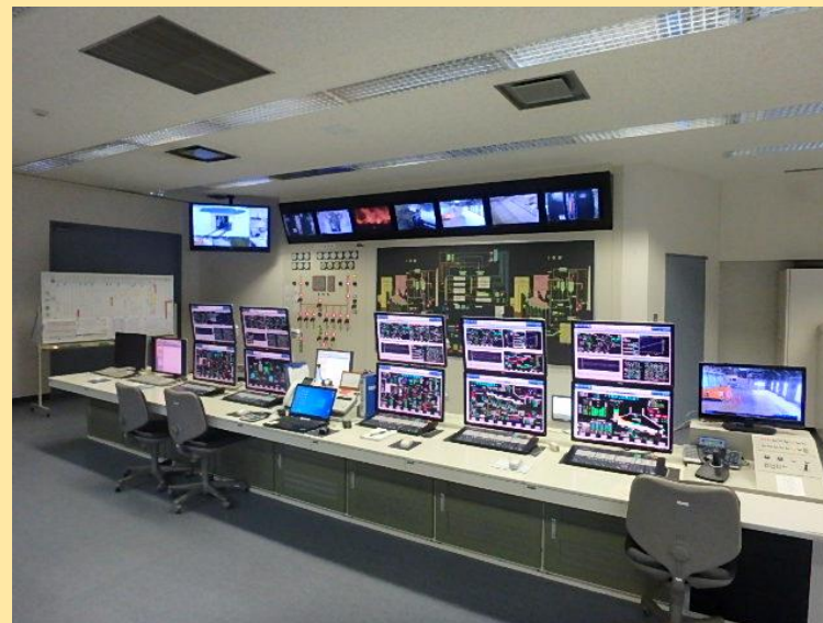
監視制御装置
