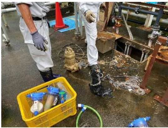
水中ポンプのスケーリング
