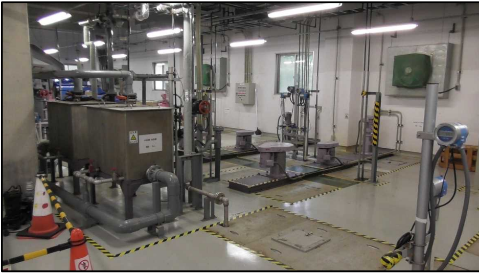
水処理施設（生物処理）
