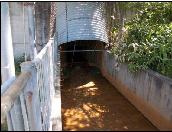
浸出水出口 (2, 3期分)
