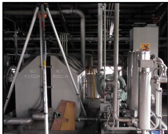
水処理施設② 内部
