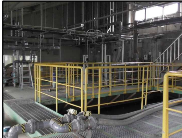
水処理施設① 内部
