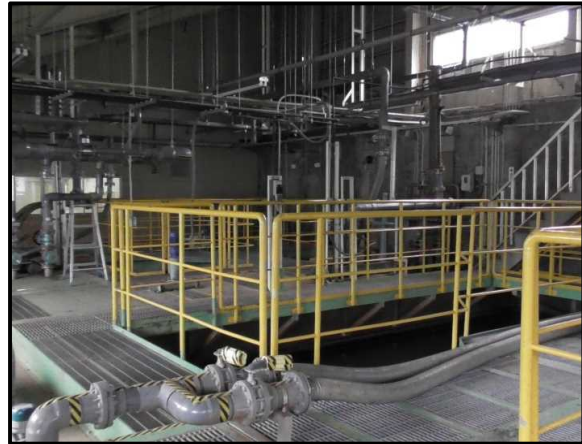
水処理施設① 内部
