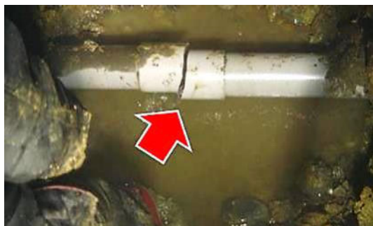
《破断した塩化ビニル管（TS 接続型継手）》
