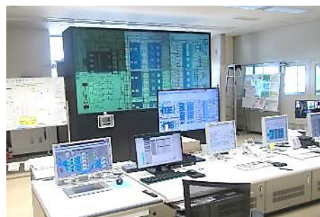
《中央監視設備》
