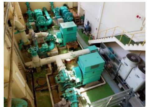
《石狩川浄水場送水ポンプ》
