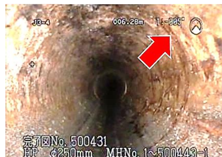
◀腐食が進み、鉄筋が露出した管▶ (コンクリート管)
