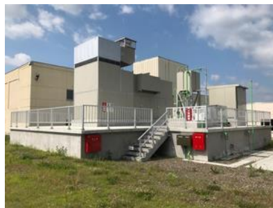
《石狩川浄水場非常用自家発電設備》
