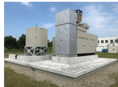
《忠別川浄水場非常用自家発電設備》
