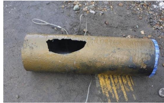
《腐食したダクタイル鋳鉄管 (GX形以外) 》
