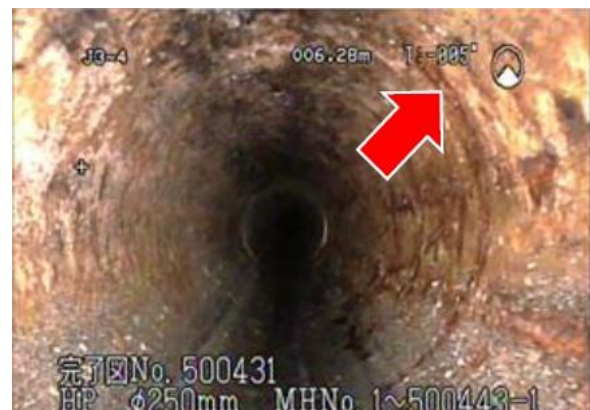
《腐食が進み、鉄筋が露出した管》
