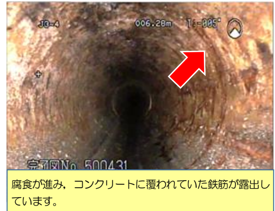
【腐食したコンクリート管】
