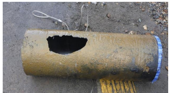
【さびて穴が開いた配水管】
