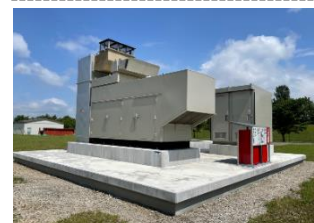
忠別川浄水場自家発電設備
