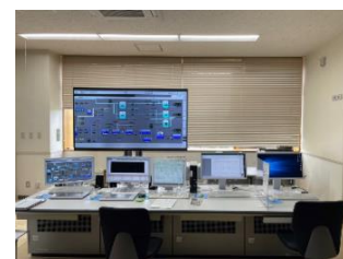
忠別川浄水場中央監視設備
