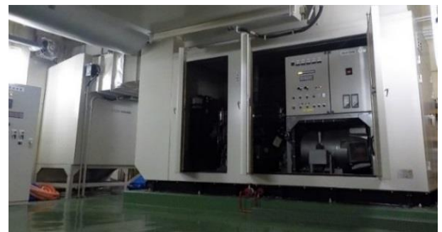
非常用自家発電設備(イメージ)
