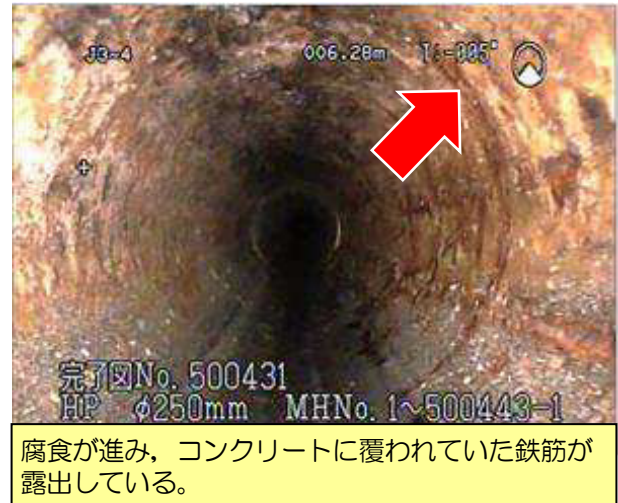
【腐食したコンクリート管】
