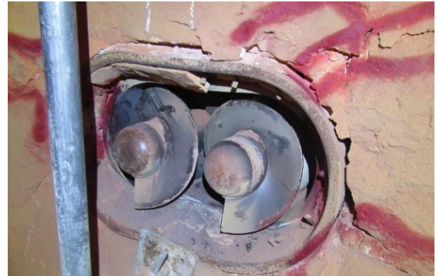
No.1 汚泥投入機 （下水処理センター焼却炉棟） 平成7年度設置，23年使用（耐用年数10年）
