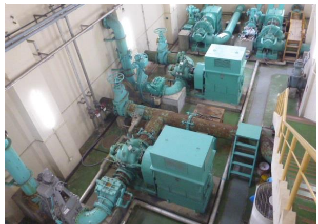
【配水場に水道水を送るポンプ（石狩川浄水場）】
