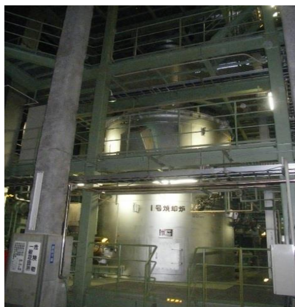
No.1 汚泥焼却炉（下水処理センター焼却炉棟） 平成 7 年度設置，23 年使用 （目標耐用年数 17 年）
