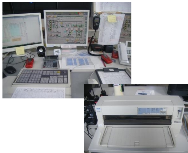
汚泥中央監視設備（下水処理センター焼却炉棟） 平成 7 年度設置，23 年使用 （目標耐用年数 15 年）
