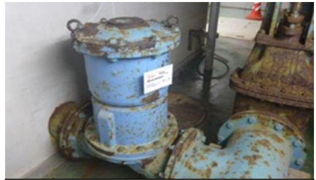
ろ過池洗浄設備（石狩川浄水場横流式沈殿池） 昭和 54 年度設置，39 年使用（耐用年数 16 年）
