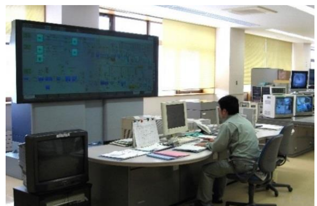
中央監視設備（忠別川浄水場） 平成13年度設置，17年使用（耐用年数16年）
