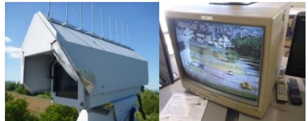
監視カメラ設備(忠別川浄水場) 平成14年度設置, 16年使用(耐用年数10年)
