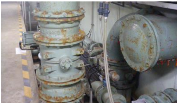
ろ過池洗浄設備（石狩川浄水場高速凝集沈殿池） 昭和 44 年度設置，49 年使用（耐用年数 16 年）
