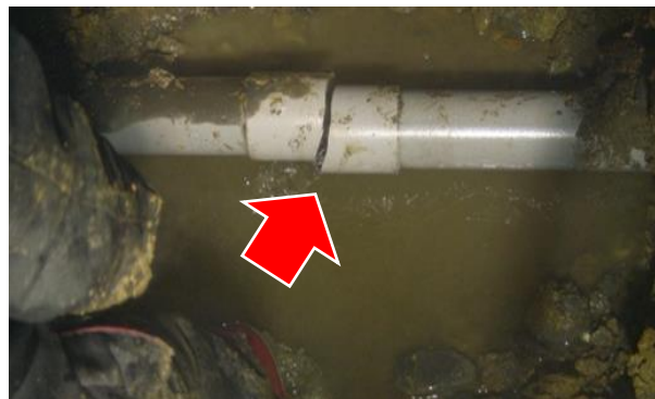
【継ぎ目が破損している塩化ビニル管】
