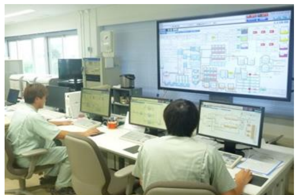
【石狩川浄水場中央監視設備】
