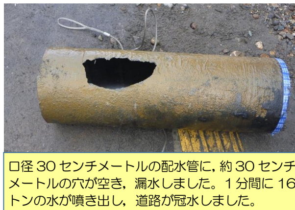
【さびて穴が開いたダクタイル鋳鉄管】
