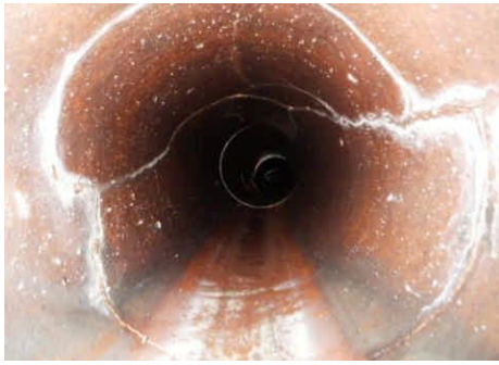
下水道管路のひび割れ状況
