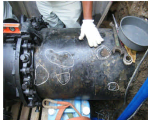
ダクタイル鋳鉄管の腐食状況
