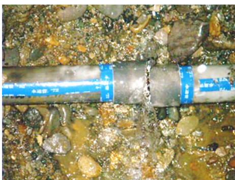
塩化ビニル管（TS 接続型継手）の漏水状況
