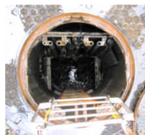
汚水マンホールポンプ
