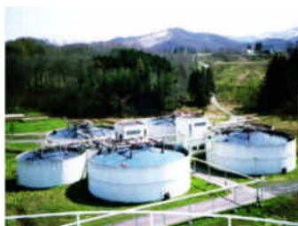
汚泥消化タンク
