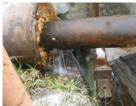
橋梁添架管の漏水状況
