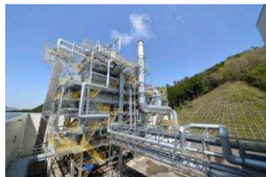
真庭バイオマス発電所
