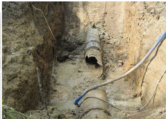
【破損した管水路】
