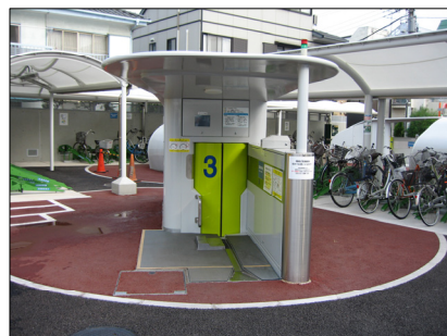
地下機械式 (三鷹市, 三鷹駅南口, 有料)
