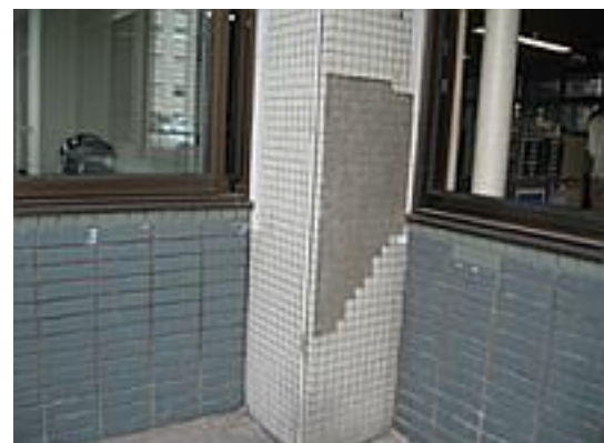
外壁タイルの剥落 (第三庁舎外壁)
