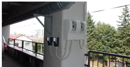
▲EV電源設備
