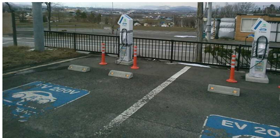
↑旭山動物園駐車場設置のEV充電器
