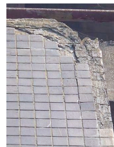
外装材等劣化の例
