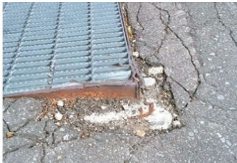
雨水桝のふたの破損
