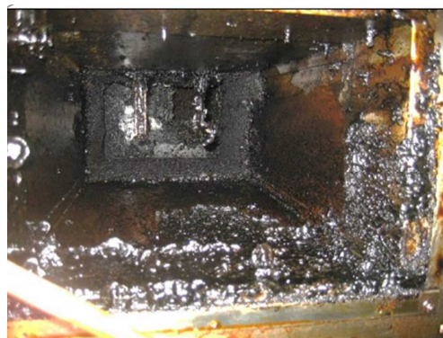
火災で燃えたダクト内（引用元：飲食店の厨房設備等に係る火災予防対策ガイドライン（東京消防庁））
