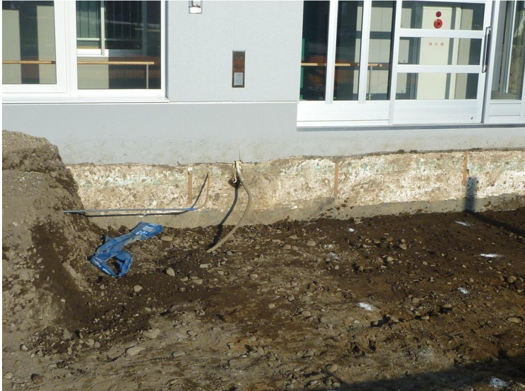
破損箇所(全景)
