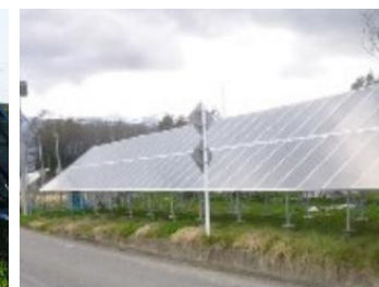
柵塀の設置されない設備
