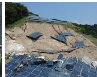
土砂崩れで生じた崩落
