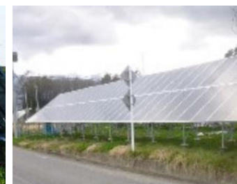
柵塀の設置されない設備
