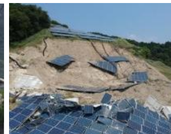
土砂崩れで生じた崩落
