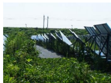
放置されたパネルの現況
