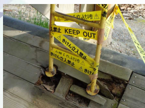
木製部材と金属の接続部の腐食
