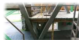
安全基準を満たしていない 主構造の柱（V字開口部）
