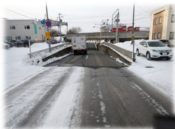
ロードヒーティング (車道)
