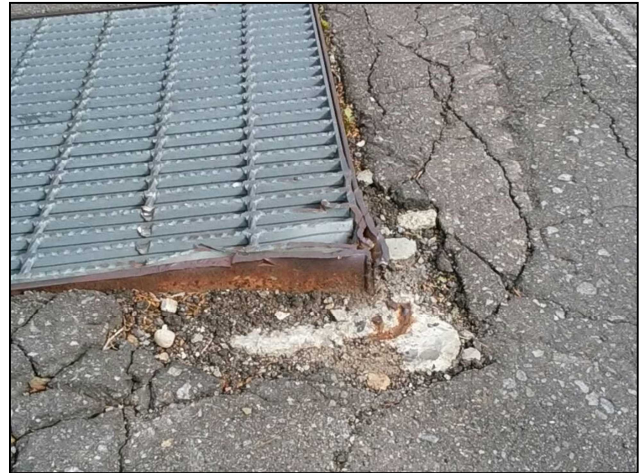
雨水枡の蓋（グレーチング）と舗装の破損
