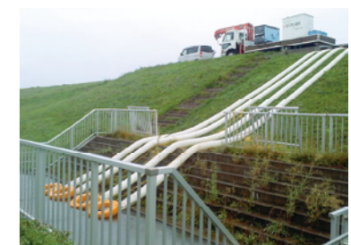
(水道局の排水ポンプ)
