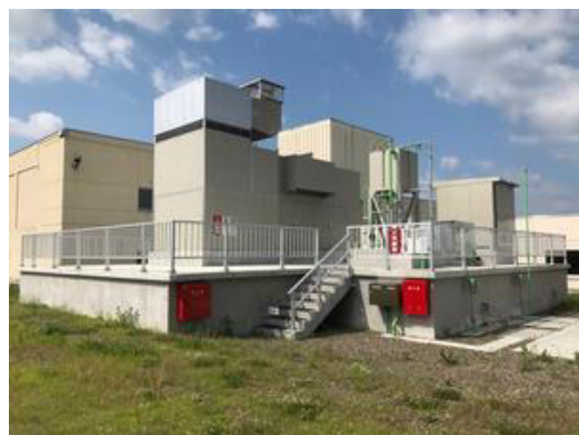
《石狩川浄水場非常用自家発電設備》
