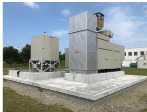
《忠別川浄水場非常用自家発電設備》
