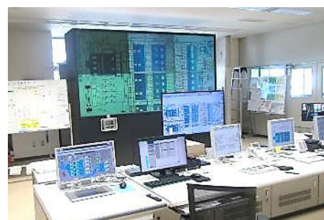
《中央監視設備》
