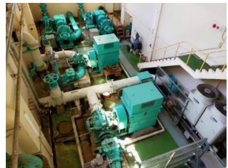
《石狩川浄水場送水ポンプ》
