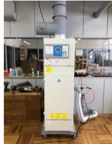
集塵脱臭機（更新後）
