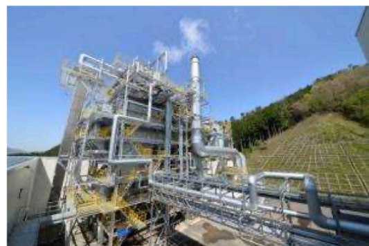
真庭バイオマス発電所
