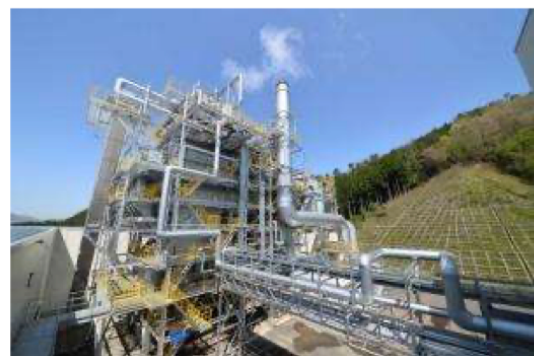
真庭バイオマス発電所
